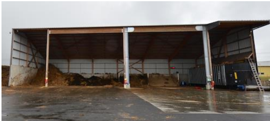
Kuva 9 Esimerkkikuva katoksesta, jossa katoksen vasemmassa päässä on biokaasulaitokselle tuotavia kiinteitä syötteitä ja oikealla kiinteiden syötteiden syöttölaite, josta materiaali siirretään ruuviyhteillä reaktoriin.
